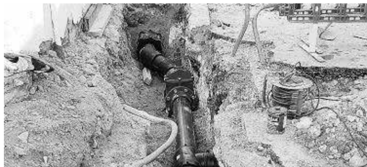
Imagen de una obra de sustitución de cañerías en el municipio de Sant Lluís a cargo de Aigües Sant Lluís. Foto: A.SLL.
